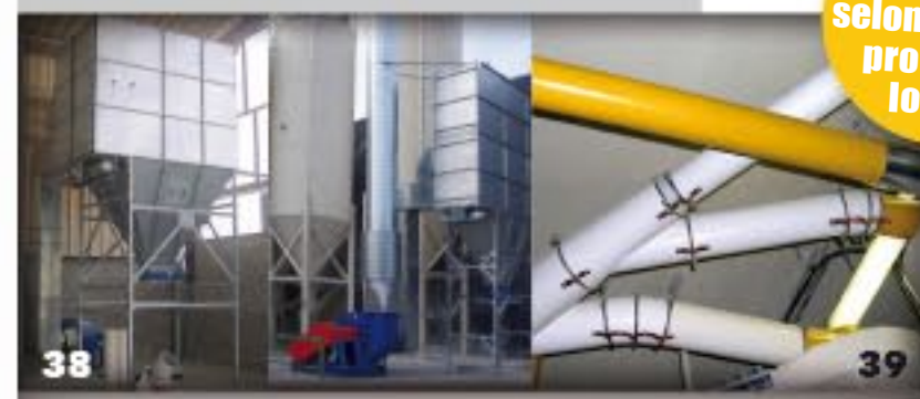
38 : Filtre de dépoussiérage à décolmatage pneumatique - 39 : Réseau d'aspiration
